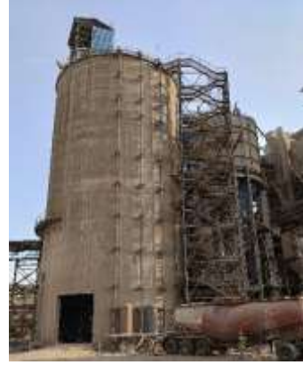
Fly Ash Silo
